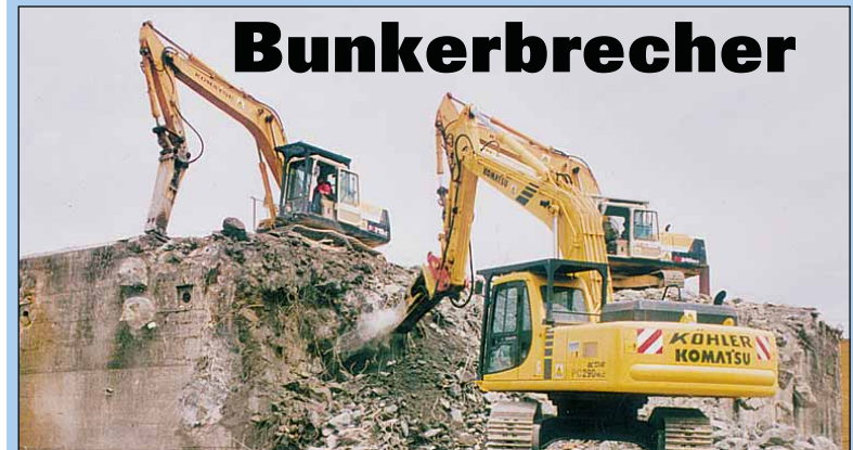
Drei Wochen schneller als geplant erledigten zwei Hydraulikanbauhammer HBC 4000 den Abbruch eines Bunkers in Schweinfurt.
