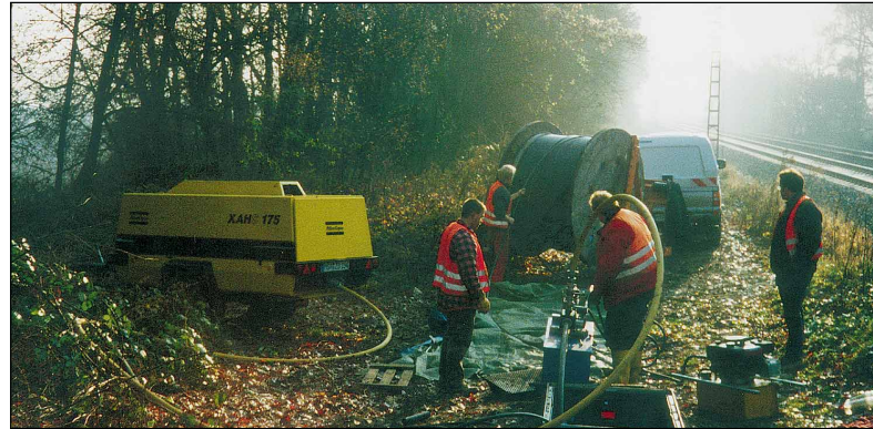
Schnell wie die Eisenbahn: Mit bis zu 200 Stundenkilometern schießt die Druckluft am Kabel vorbei durchs Schutzrohr.
